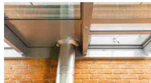
► Durchführung eines Ofenrohres im Wintergarten-Dachbereich.
